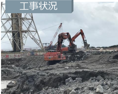
①：変圧器エリア 新設設備設置の支障となる、旧発電所のコンクリート基礎を破砕撤去します。
